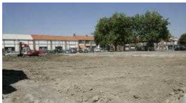
De oude Burght is gesloopt, de grond is vrij om te beginnen met de bouw van de nieuwe Burght. Het ontwerp (inzet) is al grotendeels klaar.foto Camile Schelstraete
